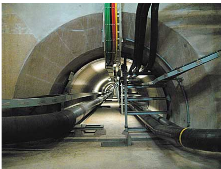
Figuur 2.1 Mogelijke probleemsituatie: meerdere netwerken (met potentieel verschillende eigenaren) op vrijwel dezelfde locatie. Foto van de leidingentunnel onder het Hollandsch Diep van Buisleidingenstraat Nederland [2]
